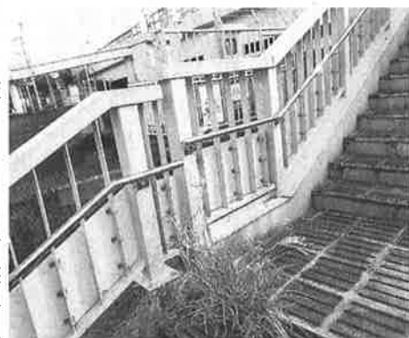
手すりはずれ、雑草も茂る歩道橋
