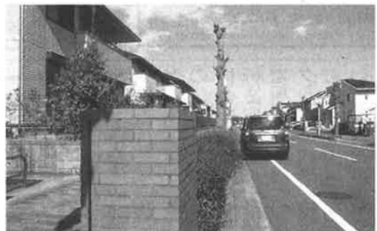
街の景色に溶け込む変庄用トランス
